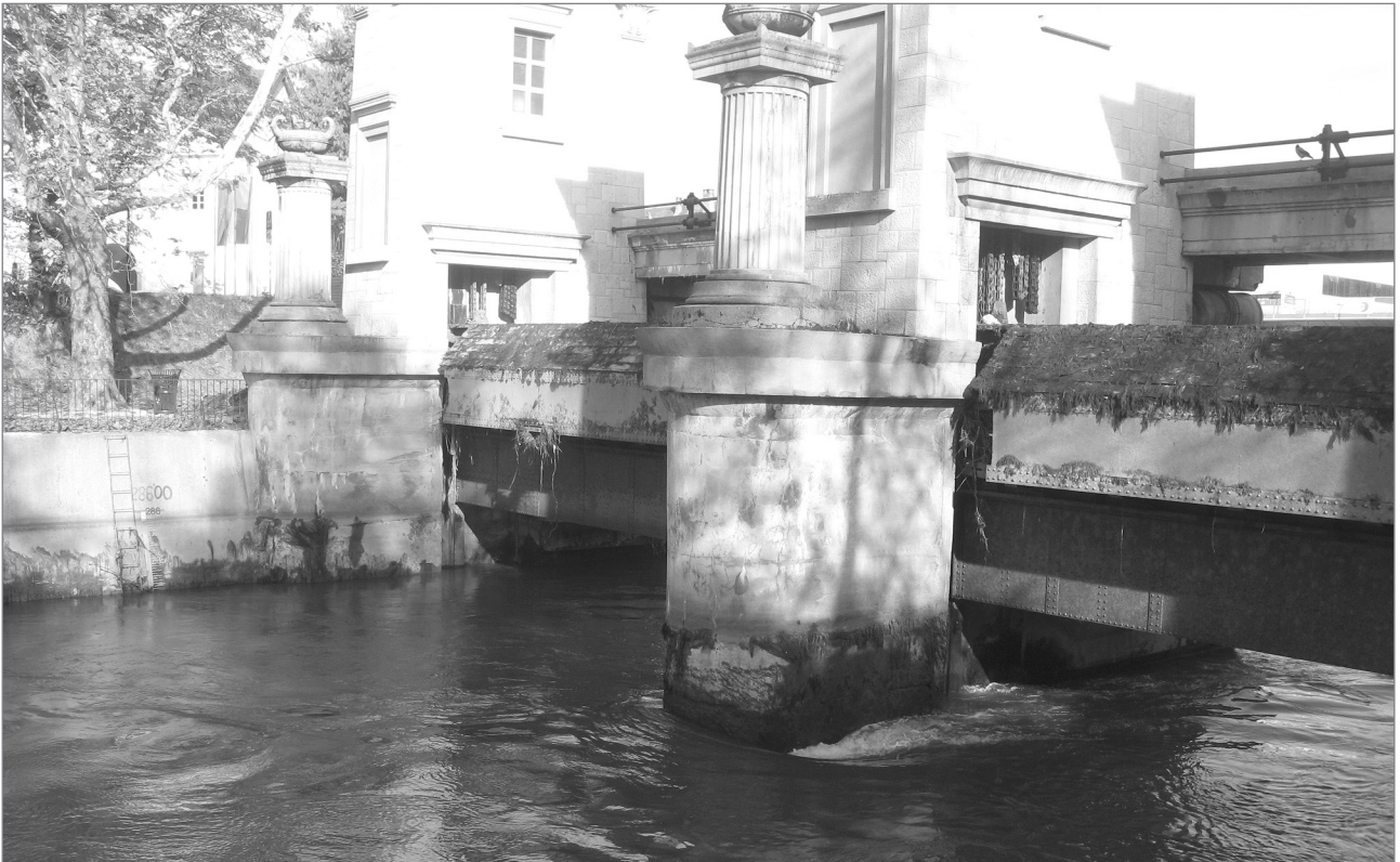
Slika 3: Dvignjene zapornice z vidno sestavo in pogonskim delom (foto: Andrej Vidmar)
